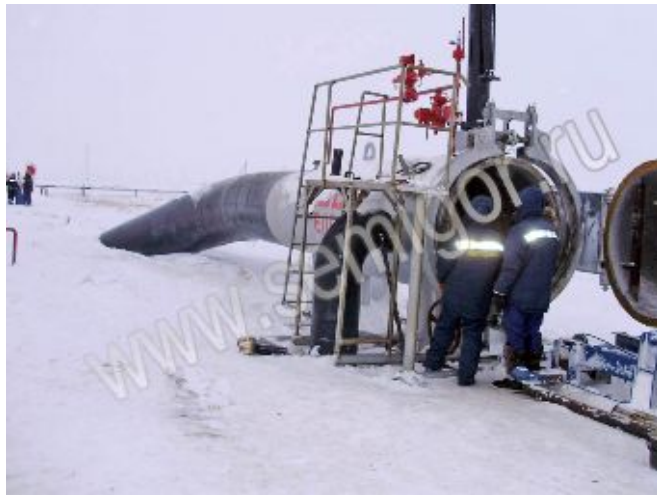
Камера запуска очистных поршней (ПК 382 ООО "Газпром добыча Ямбург") - около п. Ямбург, за полярным кругом
