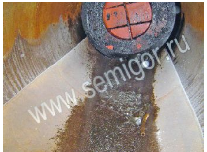
То же. В лотке грязь и мусор после очистки
