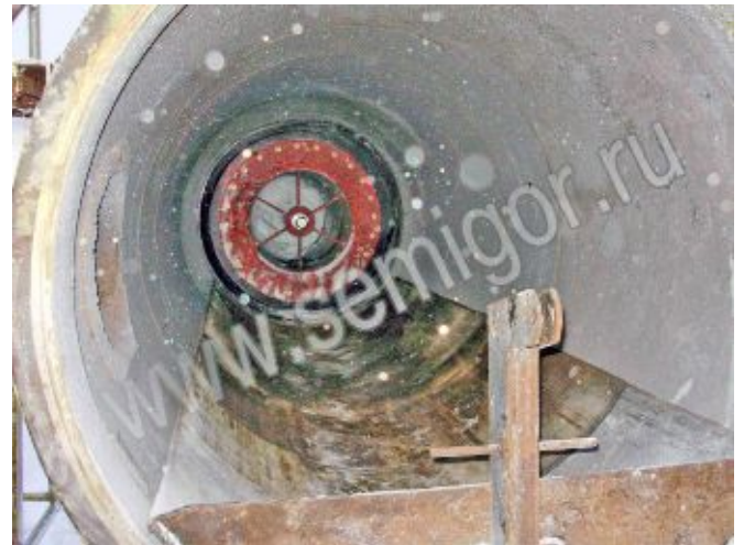
Поршень полиуретановый (манжетный) Семигор-М4-С-1420 с установленным передатчиком Семигор-С-80-95 (вид сзади) в камере запуска очистных поршней
